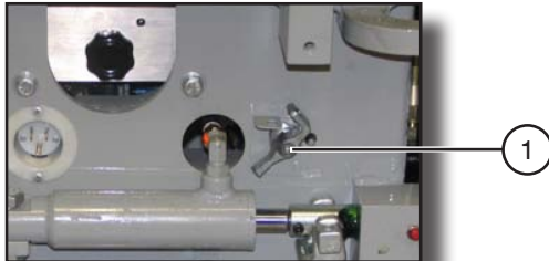
Abbildung 2-1. Hauptschalter für die Stromversorgung
